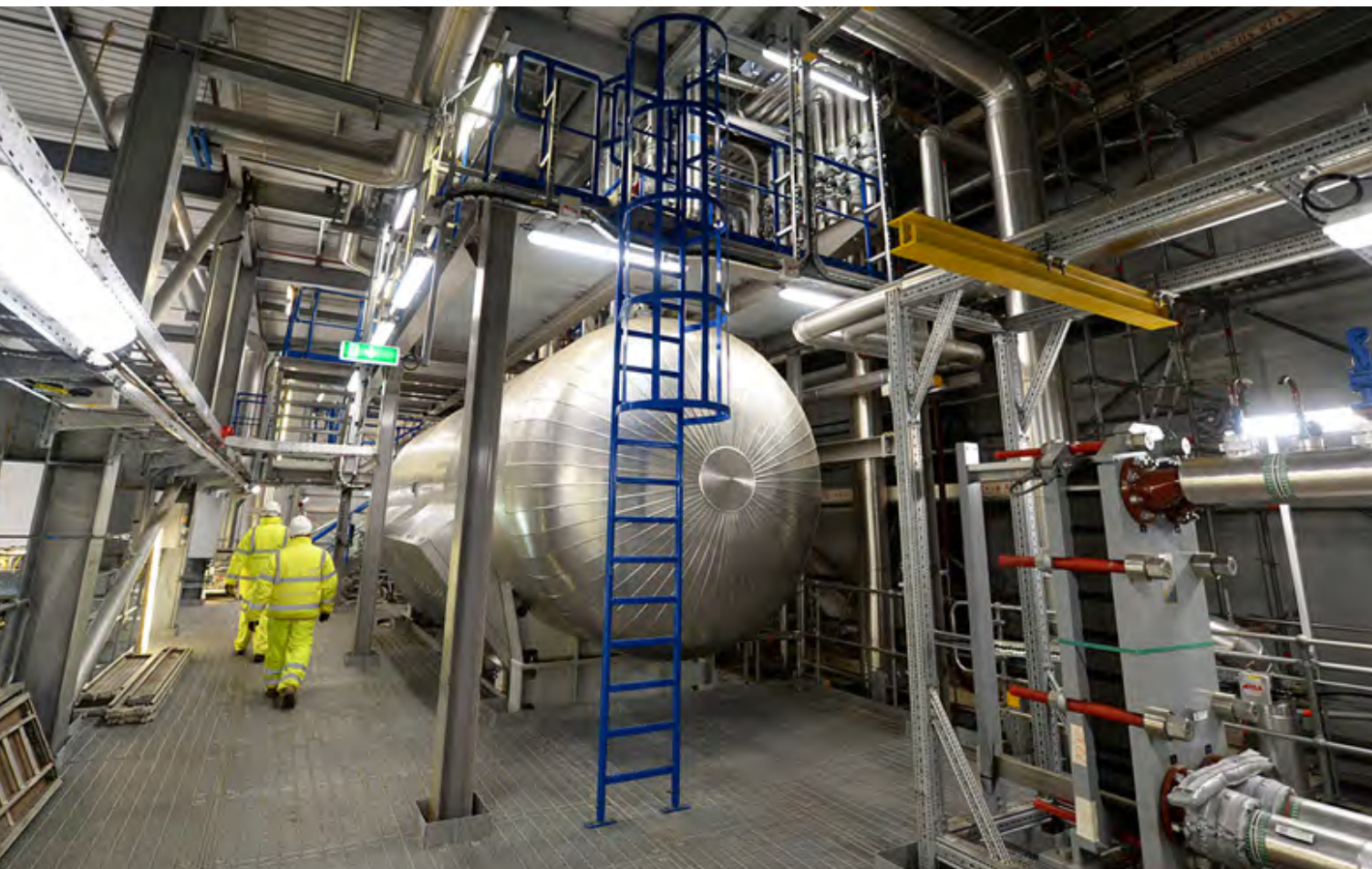
Operarios en el interior del CRRE de Millerhill, Escocia.
