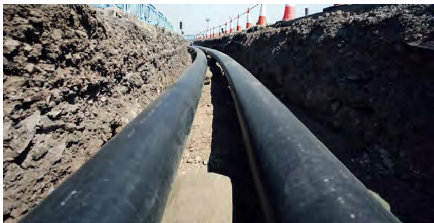
Red de calefacción comunitaria de Midlothian, Escocia.
